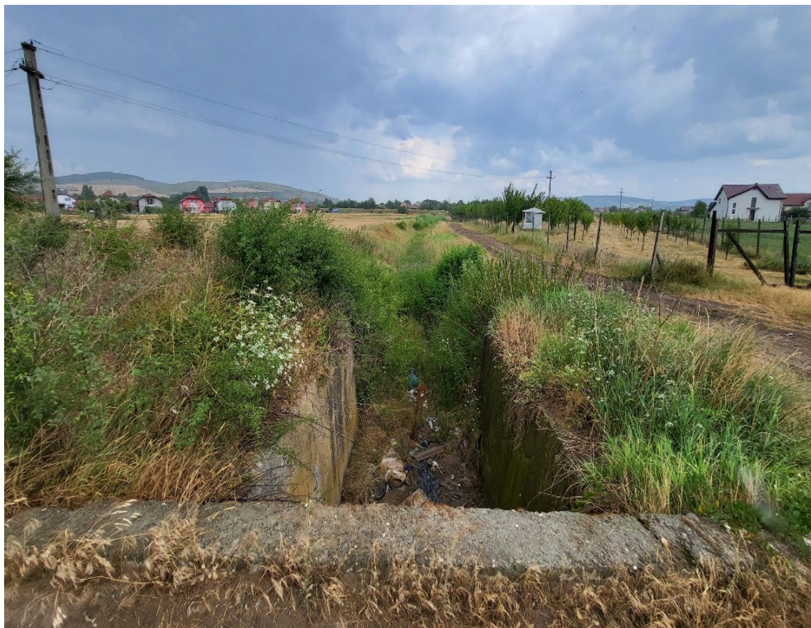
Imagine 4.10 Canal colector porțiune casetată intersecție str. Emil Racoviță
