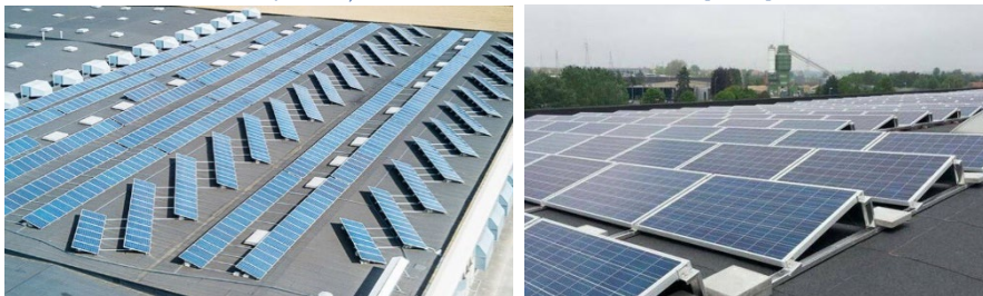
În orașul Mouscron, situat în nordul Valoniei, Belgia, autoritatea locală a stabilit un plan de acțiune pentru energie durabilă, concentrându-se pe dezvoltarea energiei regenerabile, a clădirilor durabile și a angajamentului cetățenilor. Municipalitatea a reușit să reunească părțile interesate private și publice, împreună cu rezidenți și parteneri locali, într-o cooperativă, Cooperative Energy of Mouscron (COOPEM), fondată în mai. 2017. Acest model de proprietate comună, primul de acest fel în Belgia. Prin proiectele implementate în s-a realizat o reducere a producției de CO2 cu 21% în anul 2020. [W,21]
