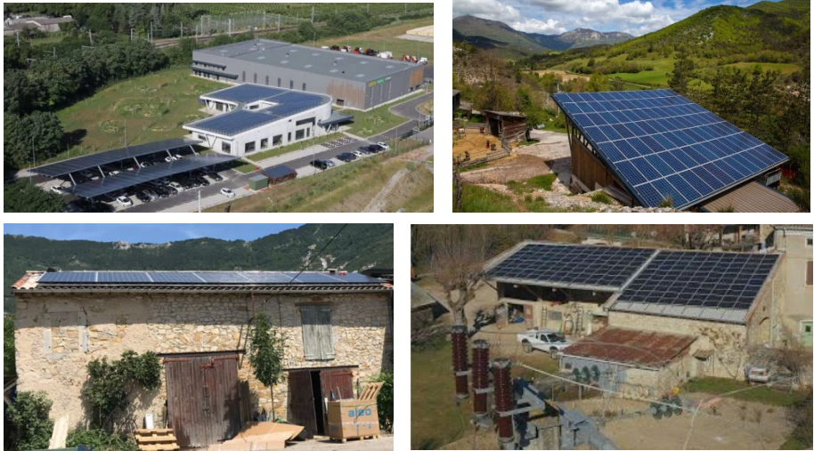
Fig.5 Cluster fotovoltaic implementat de ACOPREV [adaptare după [W.10]]
